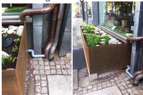
Bild 10 Biofilter plantering, påkopplat på stuprör men överskottsvattnet även påkopplat till samma stuprör (Kretslopp och vatten, 2016).
